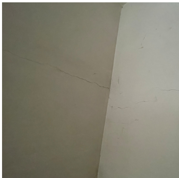
st. obývací pokoj - praskliny
