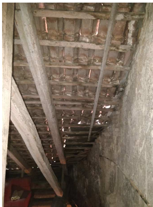
04 – Příliš velké vykonzolování latí u J štítové stěny
