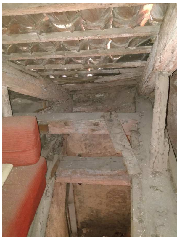
03 – Poškozené prvky krovu JV rohu nad schodištěm
