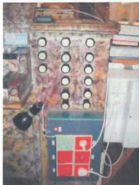
Obr. 2, 3. Dub nad Moravou (okres Olomouc), kostel Očištění Panny Marie, nevhodné elektrické instalace na varhanách.
