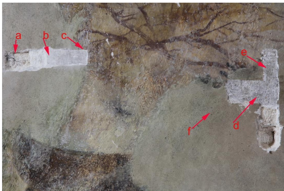
a)- jádrová hrubá vápenná omítka, b)-, utažená vápenná omítka, c)-figurální malba po roce 1770, d)-plísň napadená starší " omítka e)- figurální malba po roce 1770, f)- novodobá vápenno-cementová oprava
