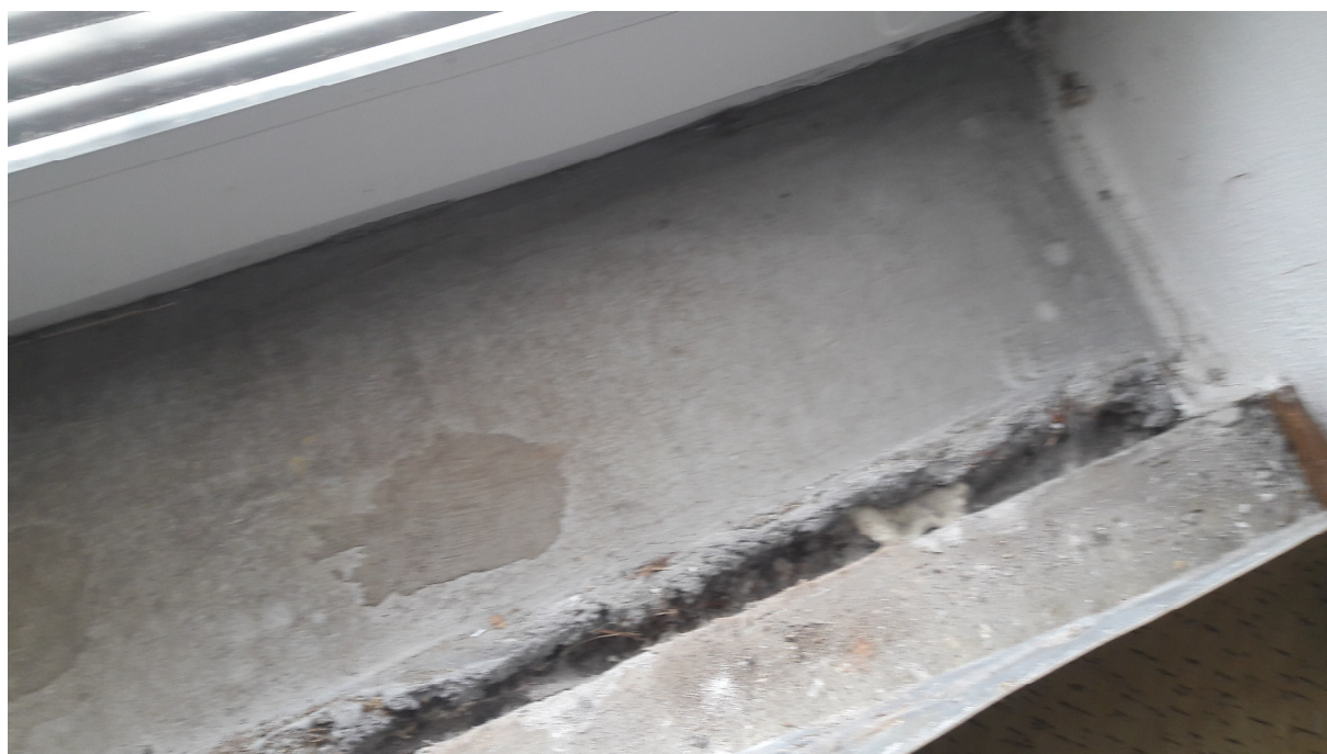
Prasklina v podlaze u balkonových dveří
